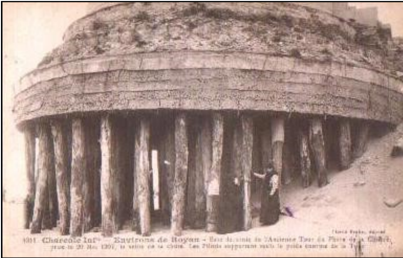
Vue de détail des pilotis enfoncés dans la dune afin de soutenir le poids de la structure de pierre et d'en maintenir l'équilibre. Le pilotis, toujours en place, ressemblent à des dents déchaussées ... (carte illustrée d'un cliché Braun)
